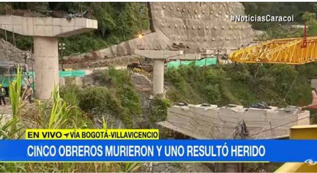
Figura 2. Accidente en el puente La Pala, en la vía Bogotá-Villavicencio, 2018. Fuente: Noticias Caracol, (27 de noviembre, 2018), choque de grúa con un andamio habría causado el fatal colapso de puente La Pala. Recuperado el 15 de diciembre de 2022. https://noticias.caracoltv.com/colombia/choque-de-grua-con-un-andamio-habria-causado-el-fatal-colapso-de-puente-la-pala
