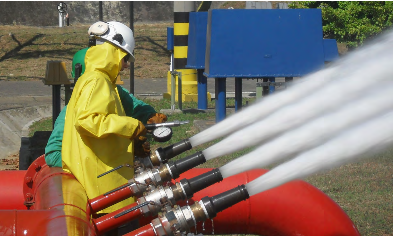
Foto: medición de caudal utilizando tubos pitot en cabezal de pruebas. Fuente: fotografía tomada por el autor. Ecopetrol, Terminal Coveñas. 2011.
