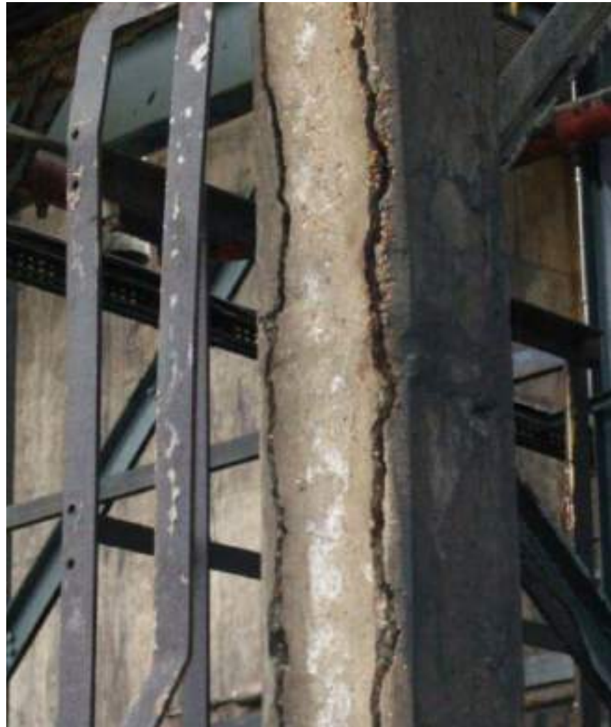
Imagen 8. Efectos de la corrosión interna en columnas. Fuente: Epolac
