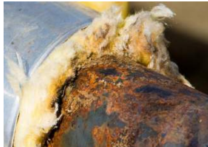
Imagen 7. Efectos de la corrosión por debajo de la protección en tubería. Fuente: Corrosion Clinic
