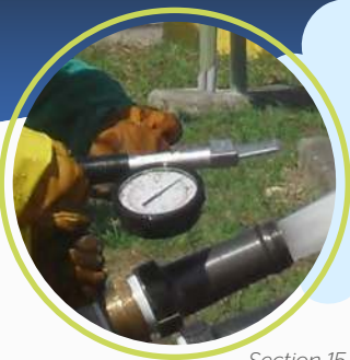
Figura 10. Medición de presión de velocidad utilizando tubo pitot
