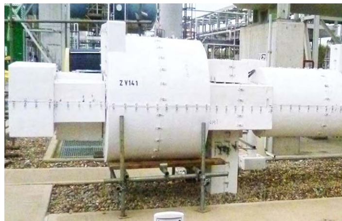
Imagen 3. Ejemplo de revestimiento para proteger válvulas y actuadores ante "jet fire". Fuente: Fireprotection
