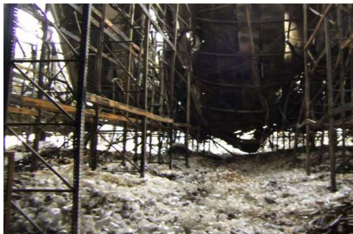
Imagen 1. Estructuras de acero afectadas por contacto directo con fuego. Fuente: ScienceDirect
