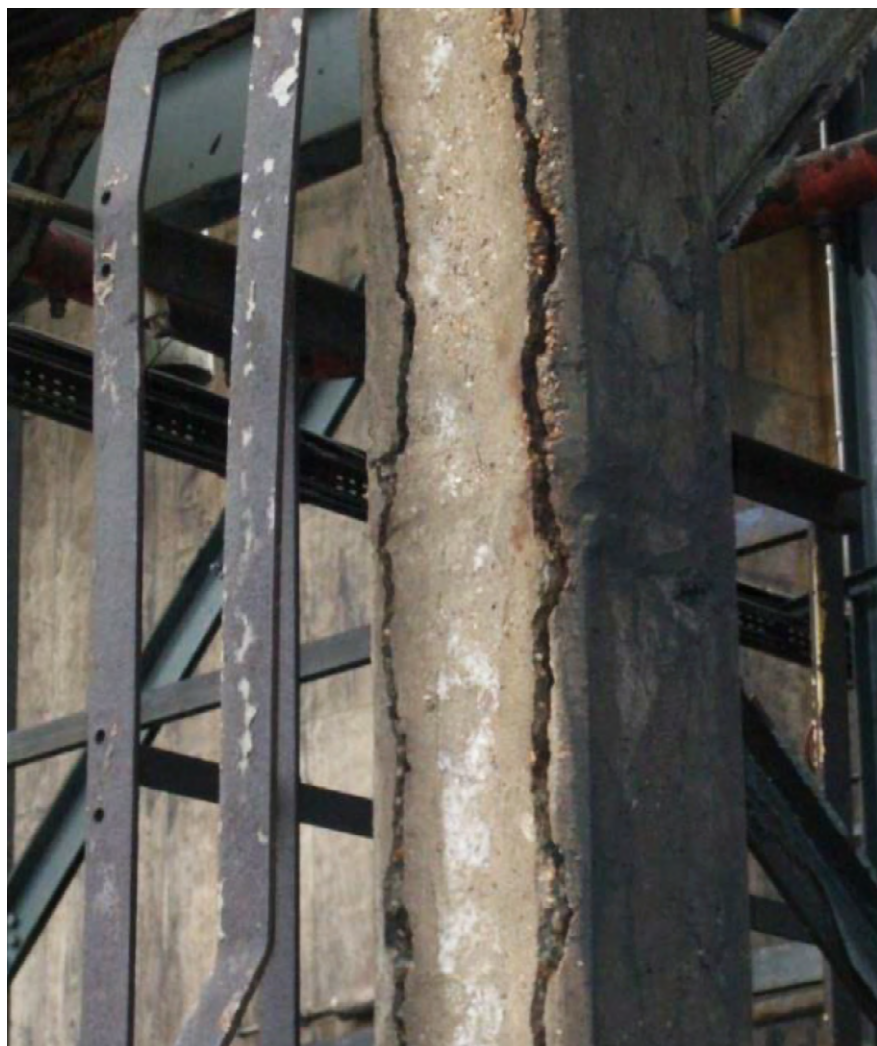
Imagen 8. Efectos de la corrosión interna en columnas. Fuente: Epolac
