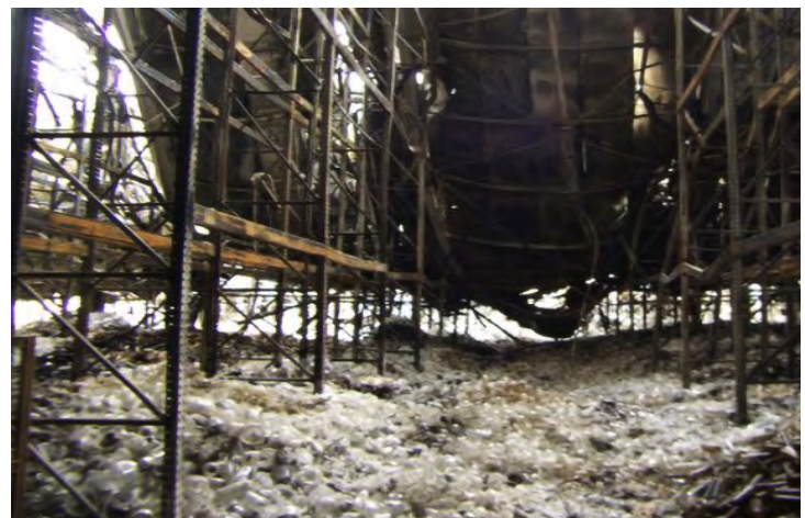
Imagen 1. Estructuras de acero afectadas por contacto directo con fuego. Fuente: ScienceDirect
