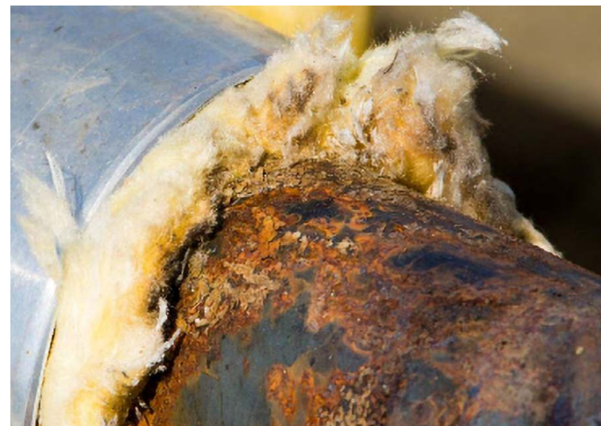
Imagen 7. Efectos de la corrosión por debajo de la protección en tubería. Fuente: Corrosion Clinic
