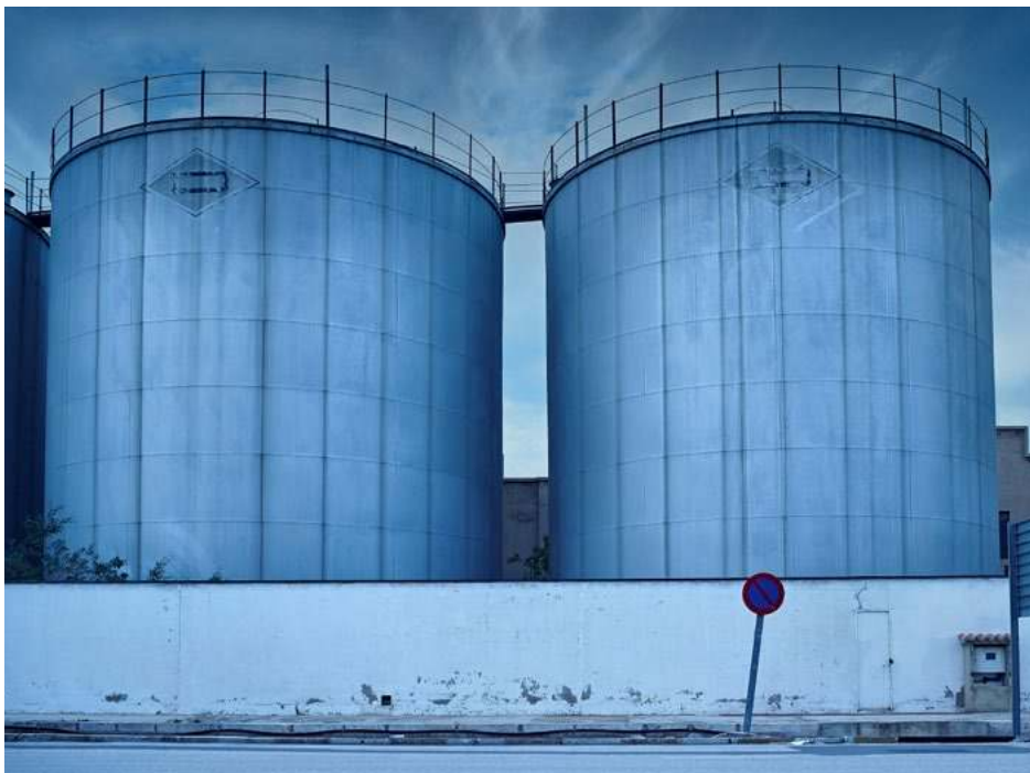
Figura 5. Tanque con corrosión
